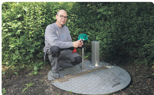
Carsten Kock viser Chatter enheden på overløbsbrønden bag det lokale forsamlingshus som indrapporterer hvert femte minut. Chatteren er fast strømforsynet fra brønden.
